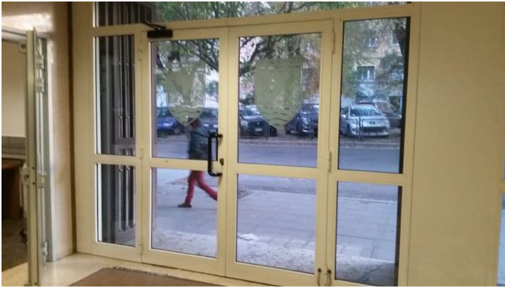
porta di ingresso al fabbricato lato Corpo di Guardia (apertura nel verso contrario all'esodo)
